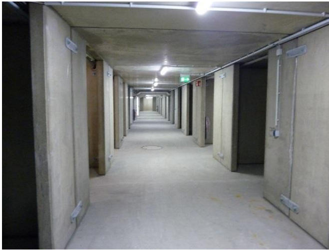
Elektroinstalace / osvětlení pod platformou
